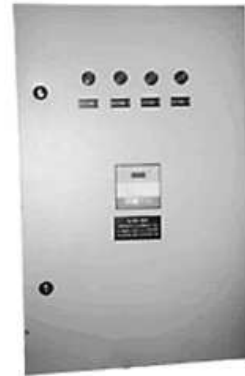
Painel do banco automático
