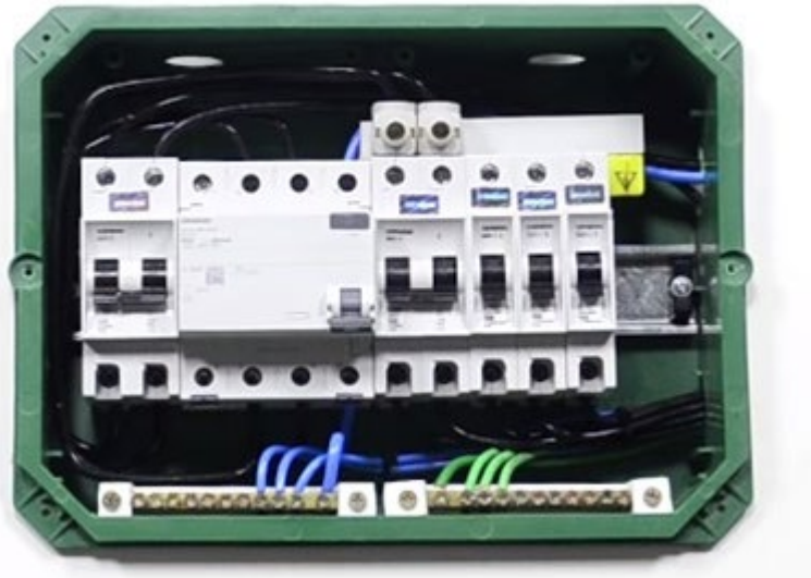
Quadro de Distribuição de Circuitos (QDC)
