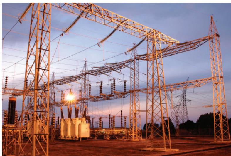
Figura 1: Exemplo de uma Subestação Externa no Paraná.
