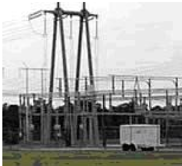
Figura 4.3 – Entrada da linha de transmissão em uma subestação.
