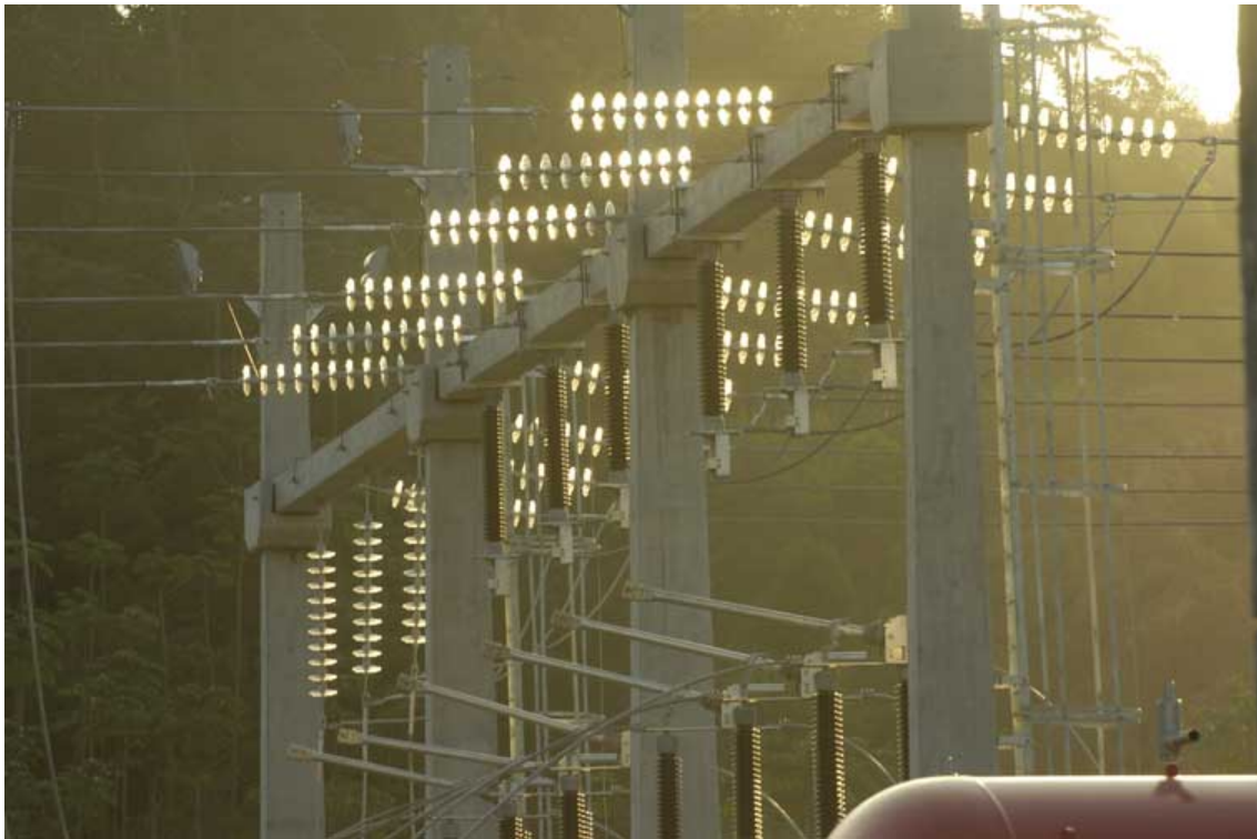
Figura 4.2 – Entrada da linha de transmissão em uma subestação.
