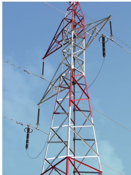
Figura 12.9 – pára-raios de sistema em torre de transmissão com pintura para sinalização.
